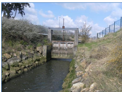
Vue aval de la vanne en position ouverte, les berges sont enrochées entre la vanne et le passage busé qui conduit à la plage.
