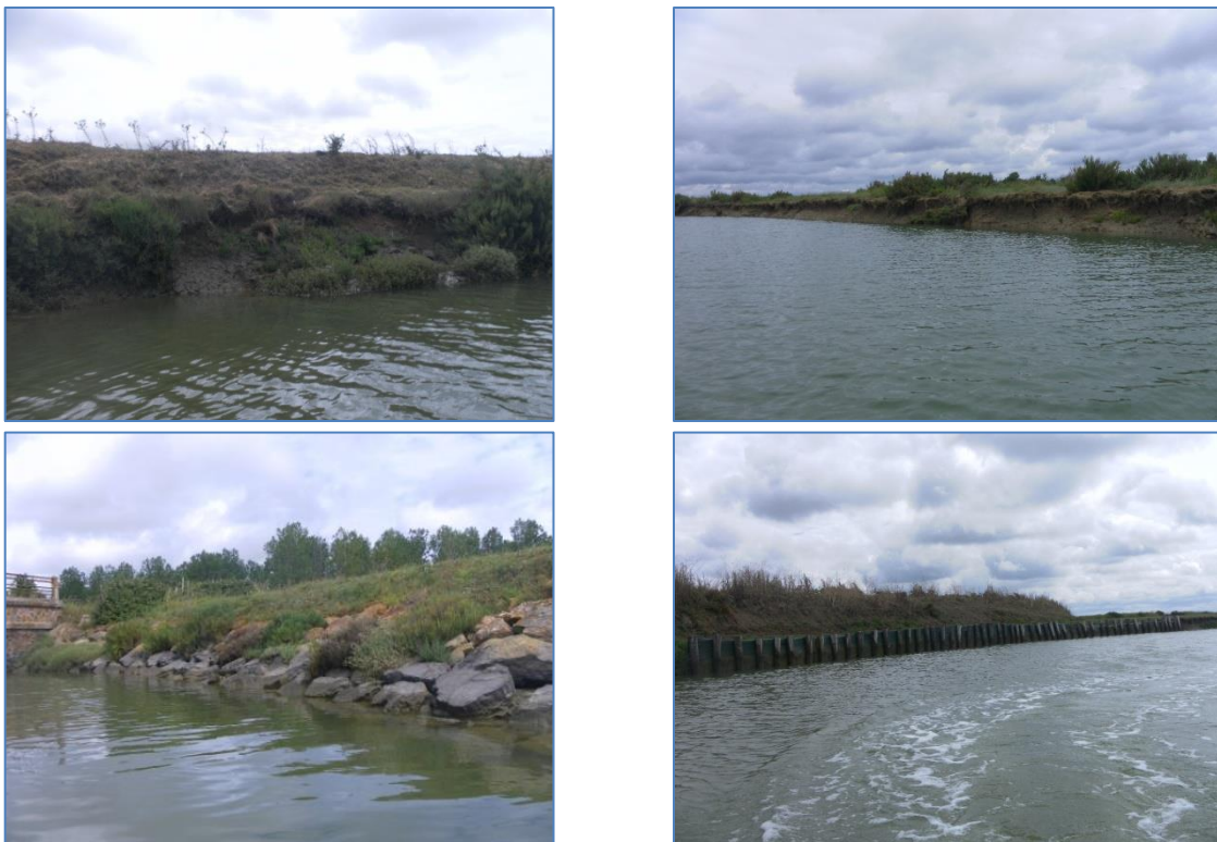
Vues de quelques secteurs d'érosion et de protection de berge sur l'Ile Bernard.
